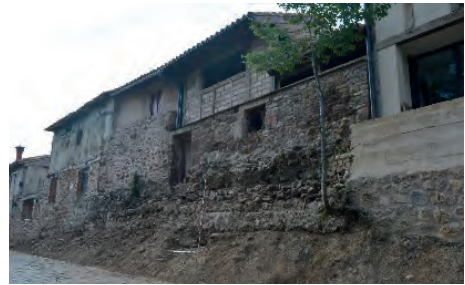
Talud natural en frente N
