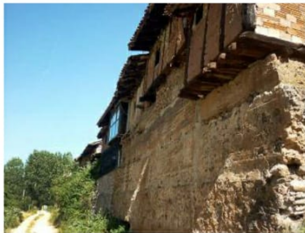
Varias casas se asientan sobre el tramo norte de la muralla. / DB
