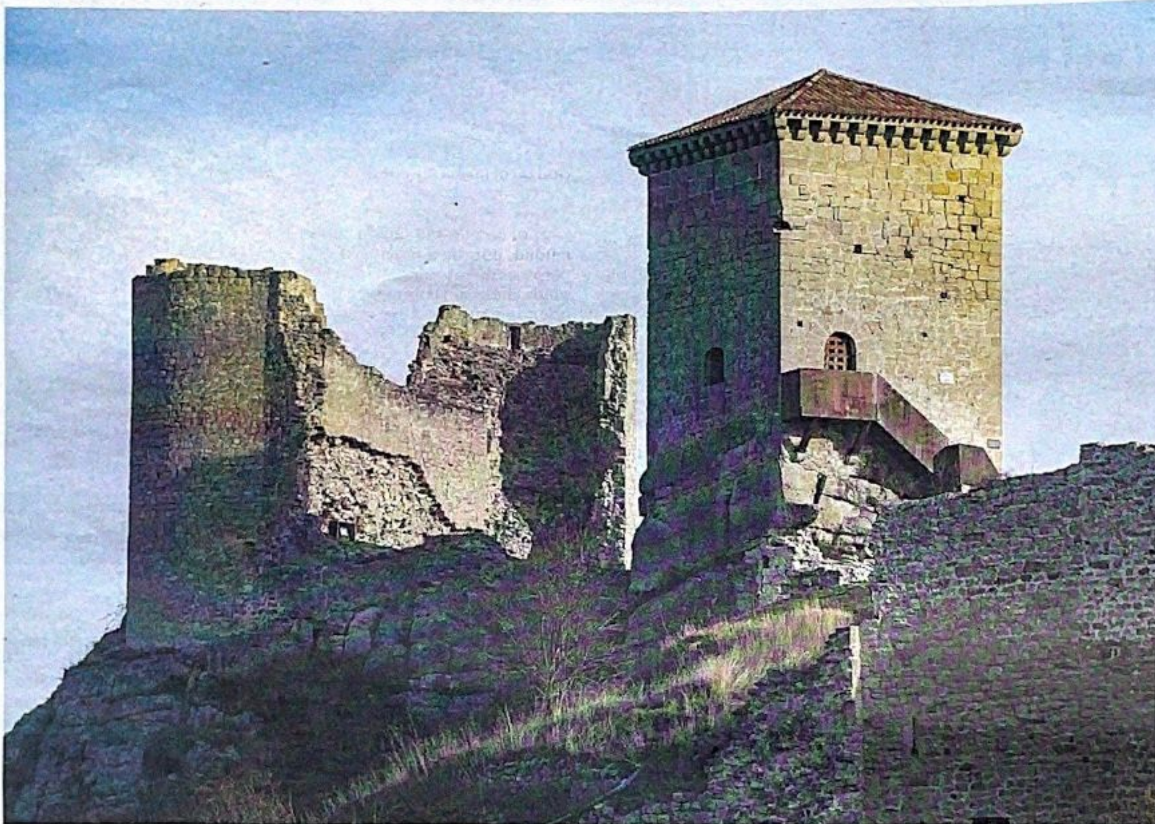
La muralla norte necesita consolidarse porque ya se han desprendido elementos. / PATRICIA
